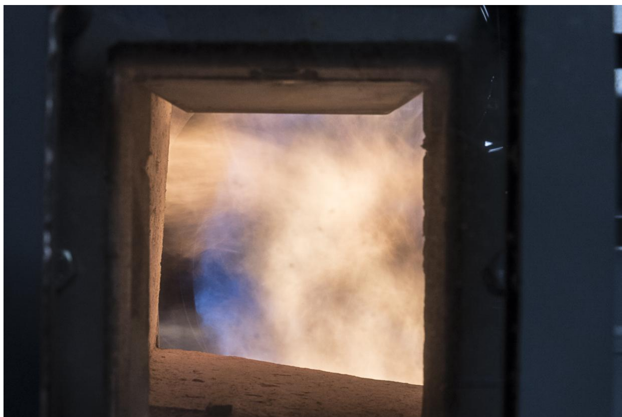
Blick in den Feuerraum des Kessel6
